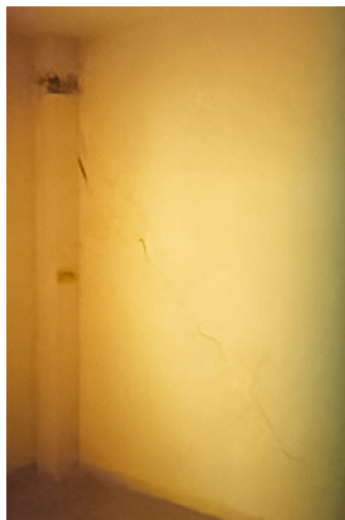
Fig. 2.- Fisura inclinada 45° por asiento.
