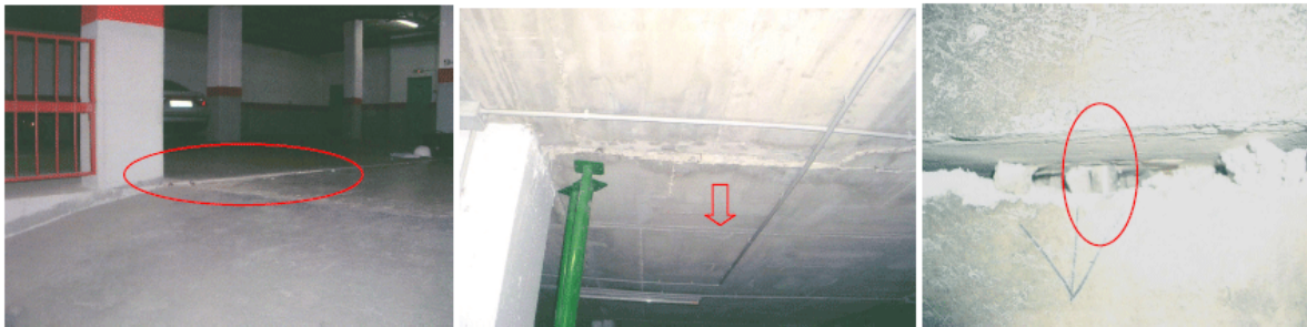
Siniestro en rampa de garaje por fallo en junta a partir de conectores provocando el descenso de uno de los paños de forjados que sustentaba.
