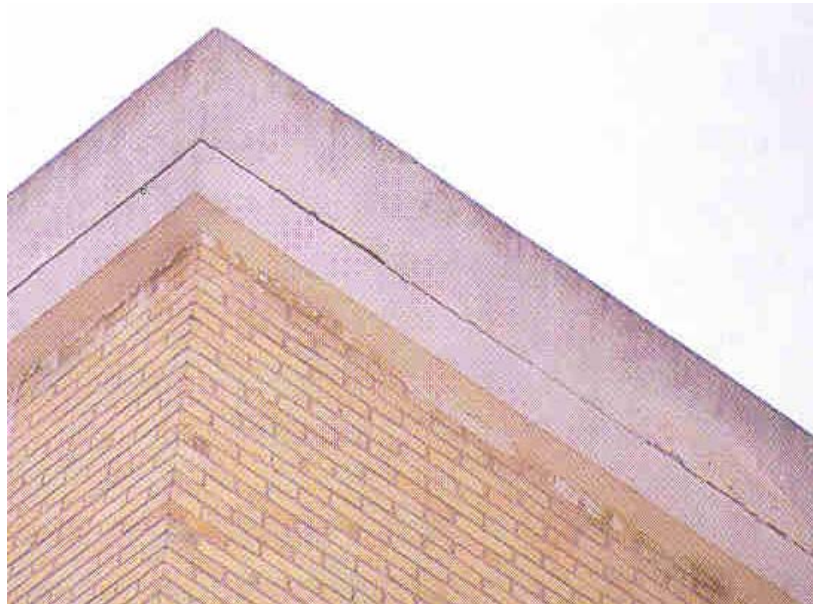
Fig. 3.- Fisura por empuje de la cubierta al peto, donde puede verse el desplazamiento de la parte superior.
